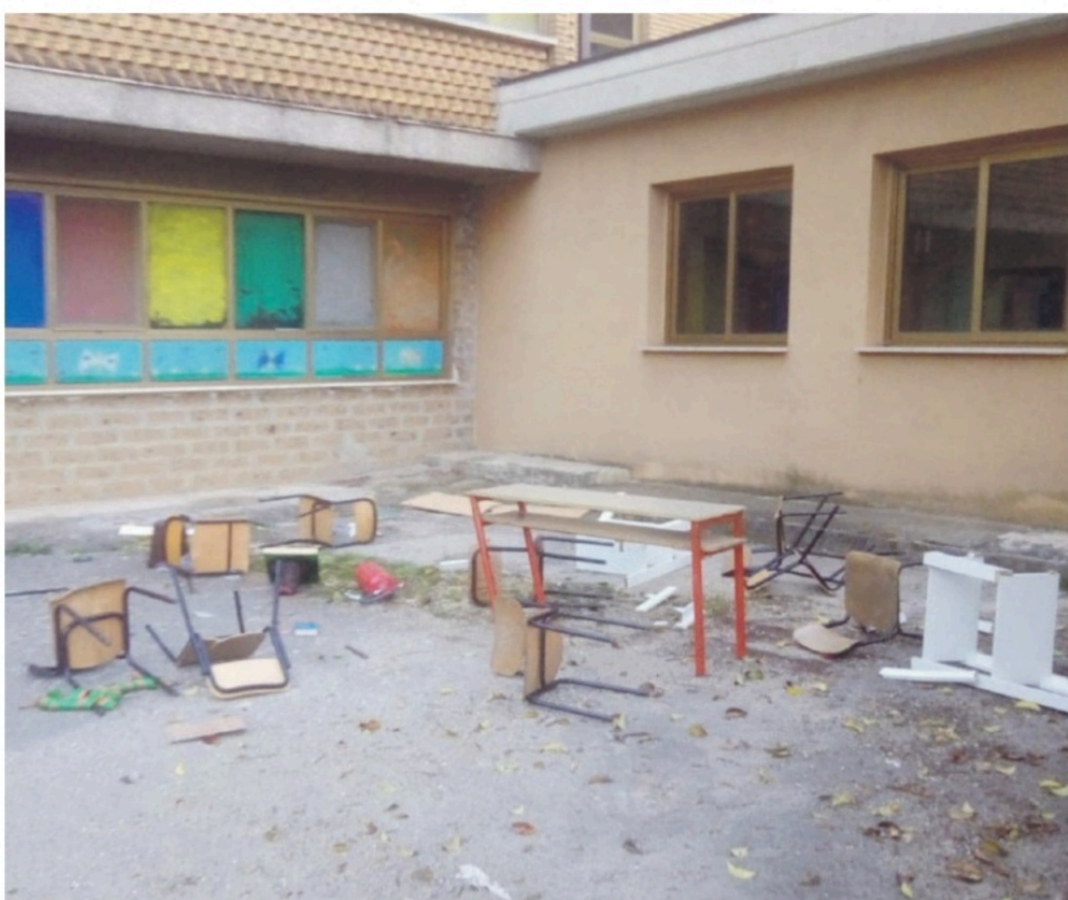
I danni lasciati dai vandali nella scuola media di via Oberdan
